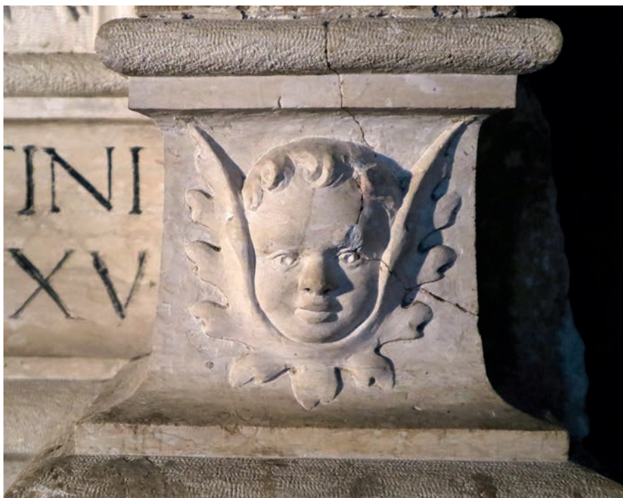
■ 4. Alessio Longhi (attribuito), Reliquiario , 1515, marmo e pietra calcarea. Vezzano, chiesa dei Santi Vigilio e Valentino (dettaglio della spaccatura e delle stuccature sul plinto destro)
