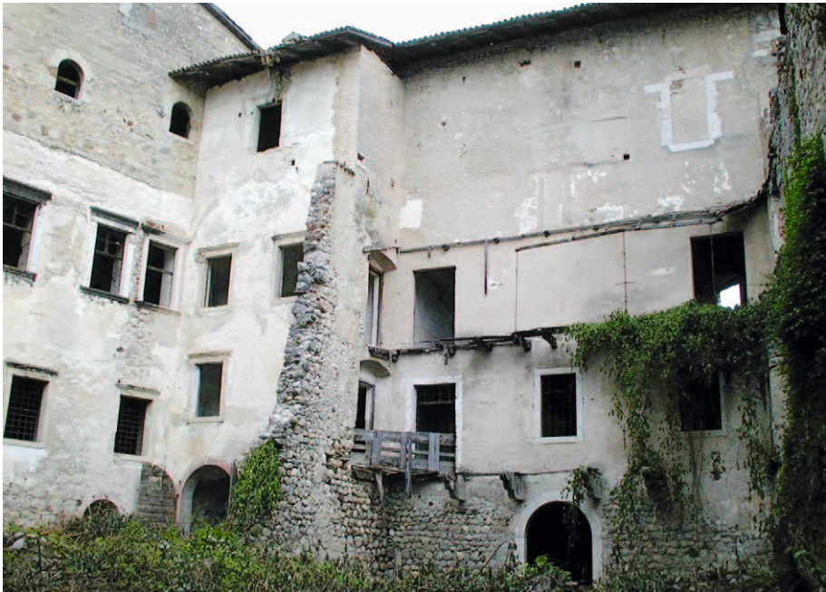
■ 7. Campodenno (Trento), Castel Belasi: particolare della parte crollata prima del restauro
