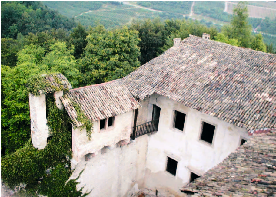
■ 5. Campodenno (Trento), Castel Belasi: bertesca ad ovest prima del restauro
