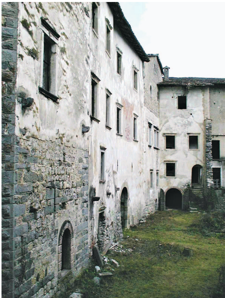
■ 3. Campodenno (Trento), Castel Belasi: particolare del cortile con il palazzo nobiliare prima del restauro
